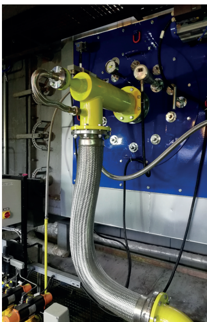
Obr. 2a,b – Detail zaústění hořáku do kotle
