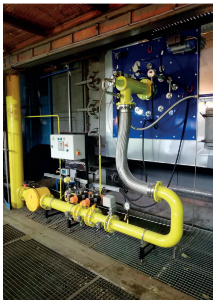
Obr. 3 – Detail zaústění hořáku s přívodem zemního plynu do hořáku
